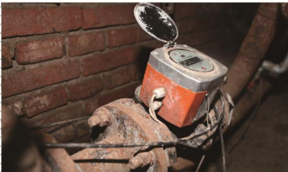
北京住建部办公区供热计量项目
