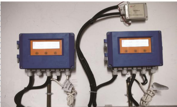
渝中热力换热站热计量项目
