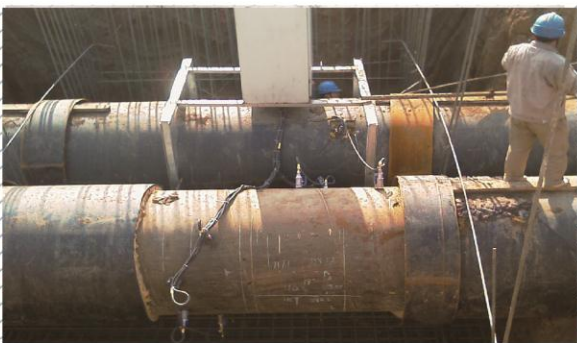
安阳热力热源厂计量项目
