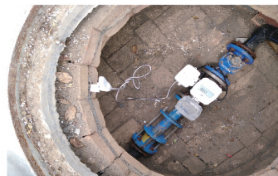
浙江某水泥厂计量项目
